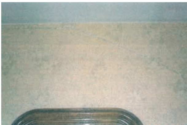
Fissuration intérieure, tapisserie déchirée - Maison André.
